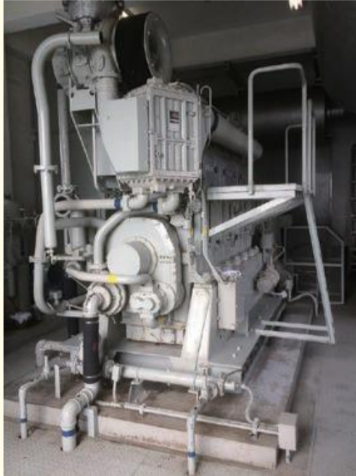
妻子原浄水場非常用発電設備(更新前)
