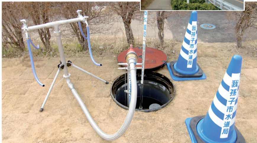
▲応急給水時の配置例(マンホール蓋を開け、応急給水蛇口をセット)
